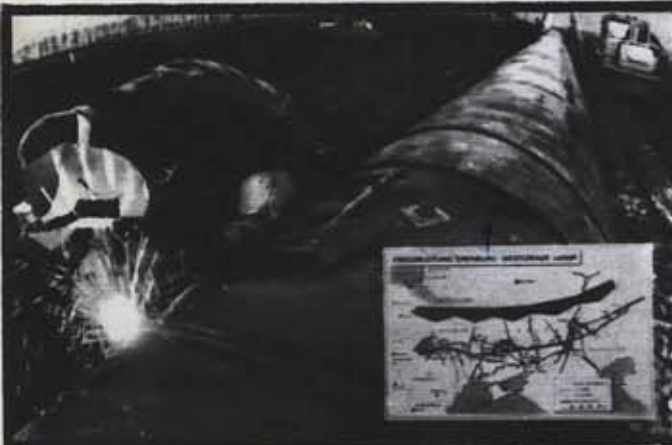
КРУПНЕЙШИЙ ОБЪЕКТ СЭВ — МАГИСТРАЛЬНЫЙ ГАЗОПРОВОД «СОЮЗ». ЕГО ТРАССА ПРОШЛА ОТ ОРЕНБУРГА ДО ЗАПАДНОЙ ГРАНИЦЫ ССР. СВОЙ УЧАСТОК МОЛОДЫЕ СТРОИТЕЛИ ИЗ ГДР ЗАВЕРШИЛИ ДОСРОЧНО. КАЧЕСТВО РАБОТ — ОТЛИЧНОЕ.
