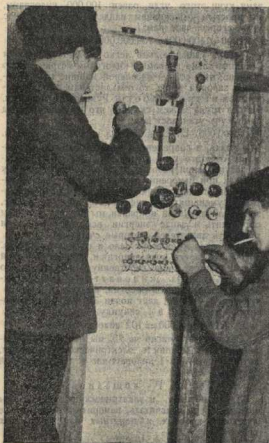
Распределительная доска, устроенная самими ребятами.
