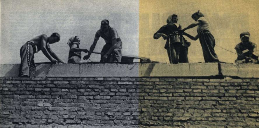
Все выше и выше в поднебесье поднимается бригада \uparrow Анатолия Дингеса, возводя корпус Энгельсовского завода синтетического волокна.
