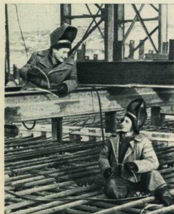
На стройке Каховской ГЭС. Дев с половинной — три марки в сумку выполняет электромонтажные работы Юрий Гоцулинский и комсомолец Сибрат Киссов.
