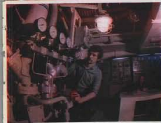
РЕФРИЖЕРАТОРНОЕ ОТДЕЛЕНИЕ. ОТСЮДА УПРАВЛЯЮТ ТЕПЛОМ И ХОЛОДОМ НА ПЛАВБАЗЕ.
