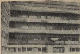
4. Массивные железобетонные балконы поддерживаются деревянными подпорами
