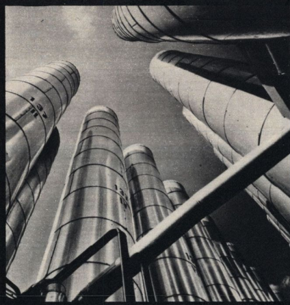
ВЕНГРИЯ. ГАЗОВЫЕ РЕЗЕРВУАРЫ ДУНАЙСКОГО НЕФТЕПЕРЕРАБАТЫВАЮЩЕГО КОМБИНАТА. СЮДА ПО ТРУБОПРОВОДУ «ДРУЖБА» ПОСТУПАЕТ СОВЕТСКАЯ НЕФТЬ.
