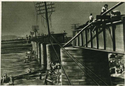
Мезелозерный мост в районе города Йоуона, разбитый американскими бомбардировщиками. Сразу же после бомбежки крестьяне окрестных сёл приступили к восстановлению моста, и через несколько часов к линии фронта здесь прошли воинские эшелоны.
