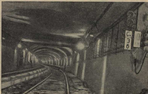
Так выглядит туннель метро, полностью оборудованный для эксплуатации
