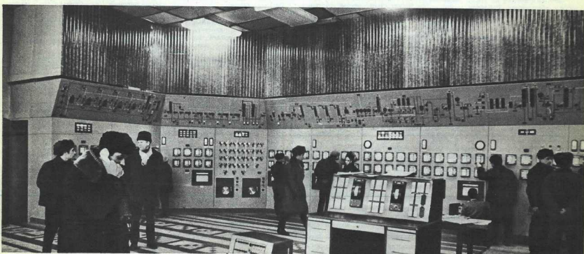
Операторская — сердце цеха.
